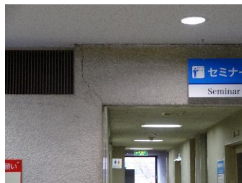
3階セミナー室前廊下（亀裂）
