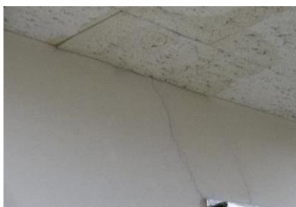
3階セミナー室前倉庫天井（雨漏跡）
